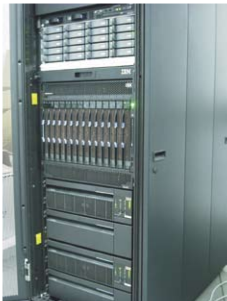
Fot. 19. Klaster komputerowy składający się z 14 serwerów w obudowie IBM BladeCenter H wyposażonych po dwa cztero-rdzeniowe procesory (łącznie 112 rdzeni obliczeniowych), macierz dyskowa 6TB, serwer zarządzający oraz zasilacze awaryjne
